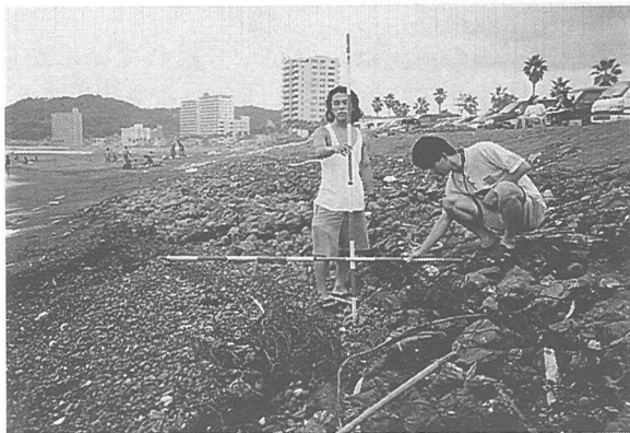
写真-9 破壊された蛇かご
