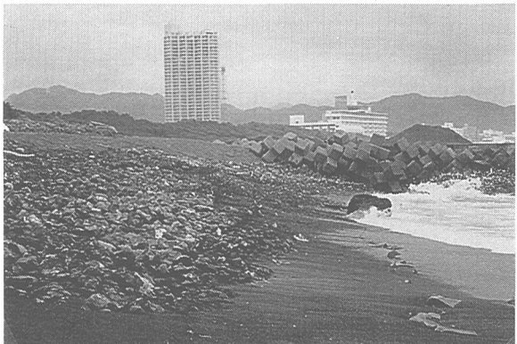
写真-8 待崎川右岸導流堤とその南西側での侵食状況
