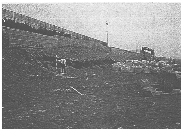
写真-1 侵食により形成された4号突堤背後の水路跡 (1997年8月7日撮影)
