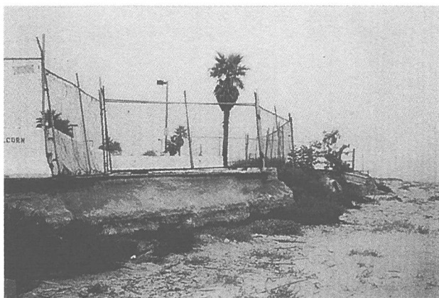
写真-9 侵食されて流出した遊歩道の基礎
