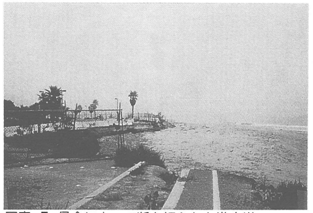
写真-7 侵食によって断ち切られた遊歩道
