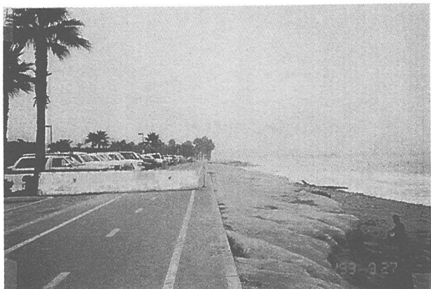
写真-10 閉鎖された遊歩道とその海側の半固結状態の土層
