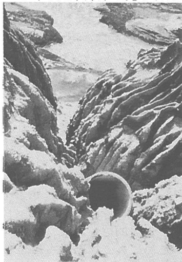
写真-4 排水路周辺で生じた著しい侵食
