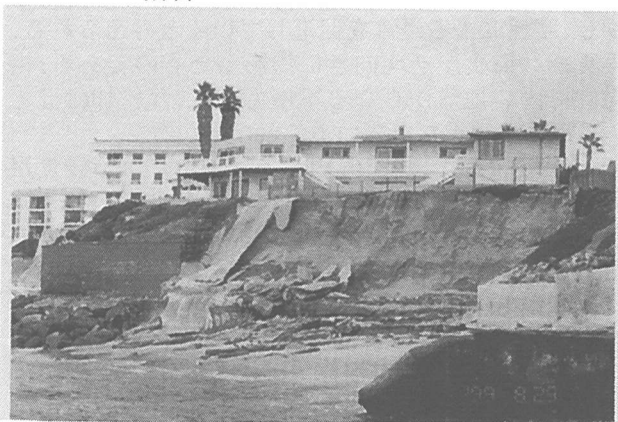
写真-11 崩壊したコンクリートのり面保護工
