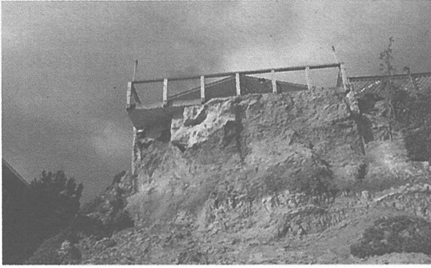
図-4 崖侵食に直面した家屋
