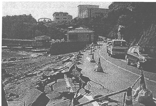
写真-5 和開橋西側付近の国道護岸の被災状況
