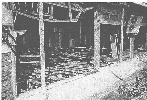
写真-6 松合地区東端の海沿寿司店一階部分の被災状況
