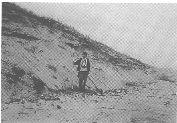
写真-12 海岸堤防の北側部分におけるのり面の侵食状況
