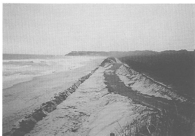
写真-11 決壊した海岸堤防の全景
