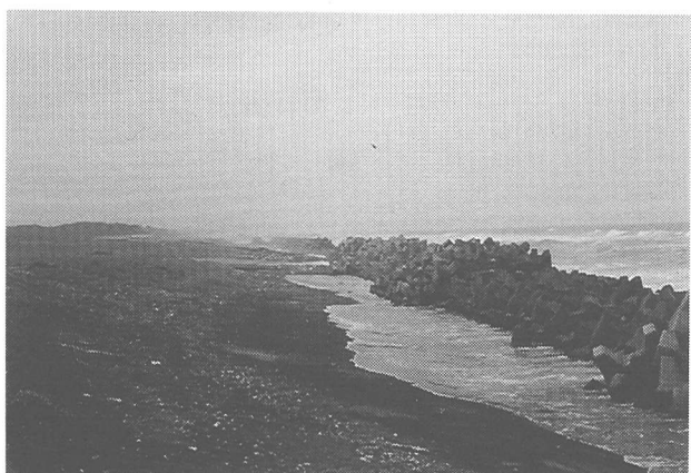
写真-13 汀線に沿って連続的に設置された消波ブロック
