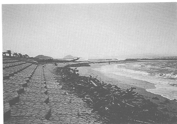
写真-12 根固めの露出状況と離岸堤背後の舌状砂州
