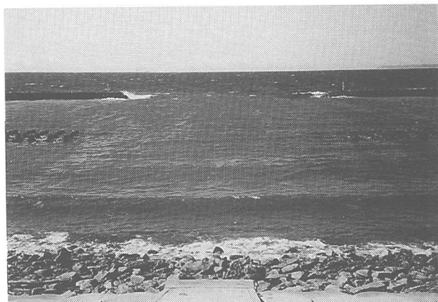
写真-13 離岸堤群の開口部と根固めの露出した緩傾斜堤
