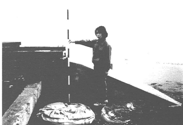
写真-15 海浜地盤高の低下によって傾いた橋の取り付け部
