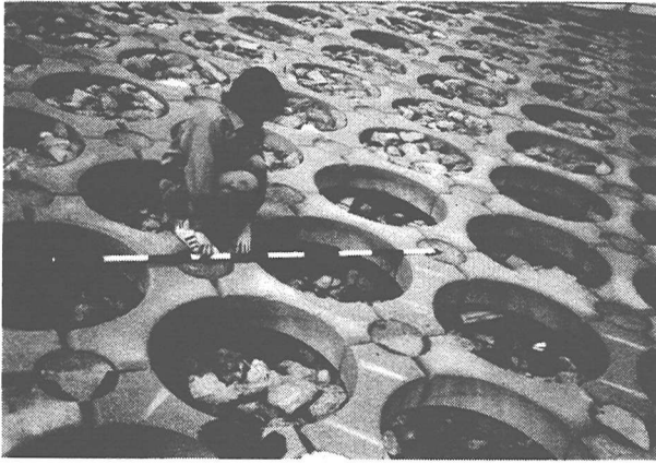
写真-16 流出したのり枠式海岸堤防の詰石
