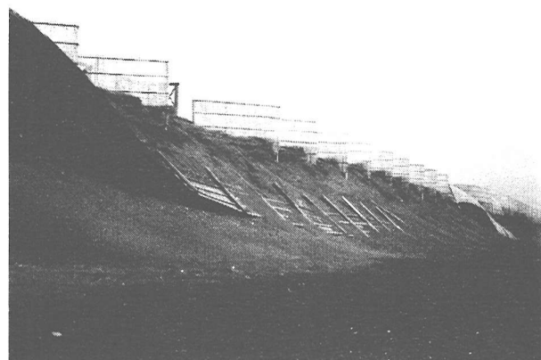
写真-10 倒壊した飛砂防止柵
