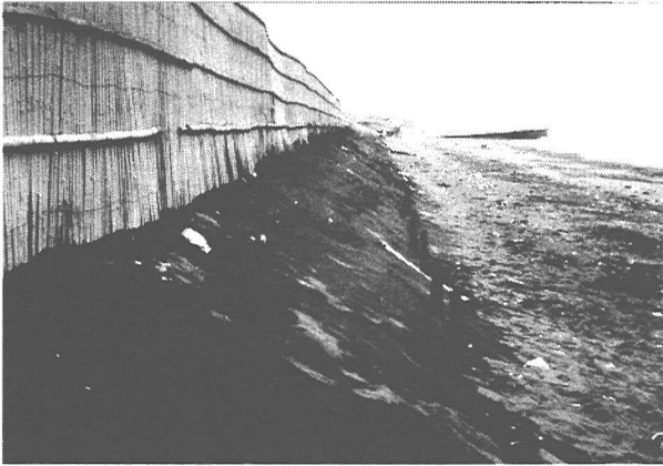
写真-1 侵食後の菱沼海岸の状況 (1997 年 9 月中旬)
