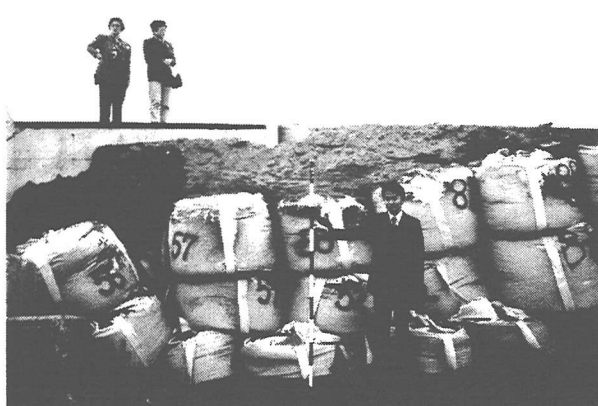
写真-13 緩傾斜堤端部の崩れつつある土嚢
