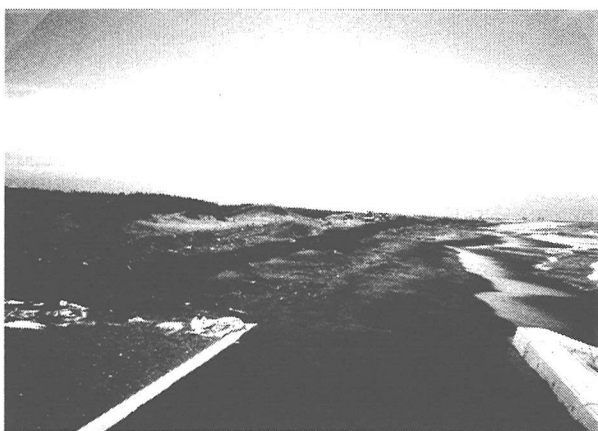
写真-12 緩傾斜堤の北端部に形成された浜崖
