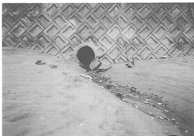
写真-3 道路護岸下部の排水口周辺の海浜状況
