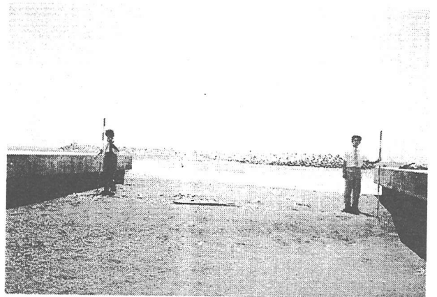
写真-17 5号水路の河口導流堤間の土砂堆積状況
