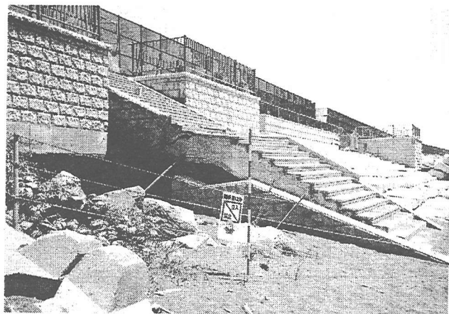
写真-1 茅ヶ崎海岸のBMS試験施工区域における侵食による階段の被災状況 (1997年7月3日撮影)
