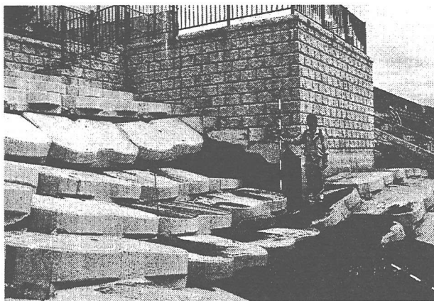
写真-15 基礎を大きくえぐり取られた展望台と沈下したテラスブロック
