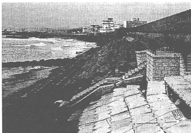
写真-14 茅ヶ崎地先の展望台から西側の海岸状況
