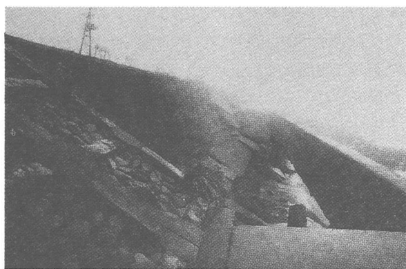
写真-8 写真-7 と同一地点における海岸堤防の崩壊状況（1997 年 9 月 3 日撮影）
