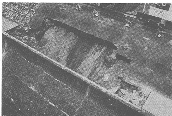
写真-5 写真-4 と同一地点における海岸堤防の被災状況（1997 年 8 月 25 日撮影）
