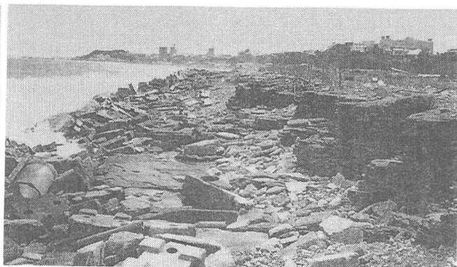
写真-10 護岸背後の埋立土の侵食状況
