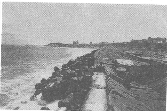
写真-8 護岸の傾動によって傾いた 護岸背後のコンクリートブロック
