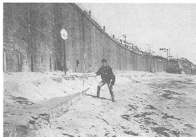
写真-9 七里ヶ浜西端近傍に形成された浜崖
