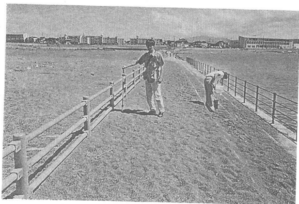
写真-3 A突堤天端上の土砂の堆積状況
