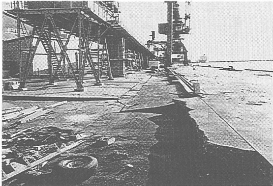
写真-1 a 2埠頭南岸壁-12m（対策無）
