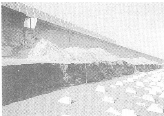
写真-6 2号ヘッドランドの南側隣接部における 浜崖形成状況
