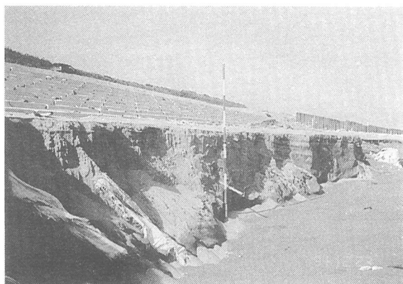
写真-10 浜崖の詳細状況
