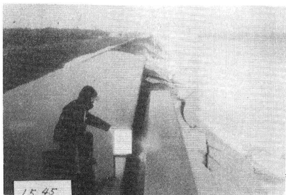
写真-9 静岡県駿河海岸の海岸護岸の被災 (川尻地先)(1972年10月31日, 15:45)
