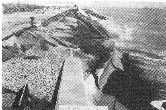
写真-10 静岡県駿河海岸の海岸護岸の被災 (川尻地先)(1972年11月1日)
