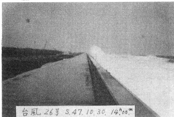
写真-5 静岡県の駿河海岸の海岸護岸の被災 (川尻地先)(1972年10月30日, 14:00)
