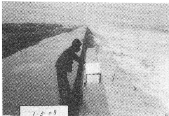
写真-8 静岡県の駿河海岸の海岸護岸の被災 (川尻地先)(1972年10月31日, 15:08)
