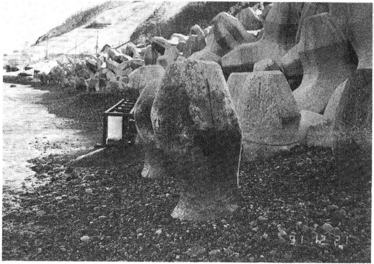
写真-1 現地での漂砂摩耗状況
