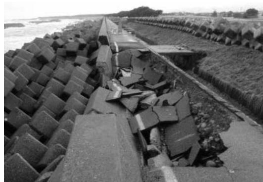
写真-8 堤体土砂吸い出しによる破堤
