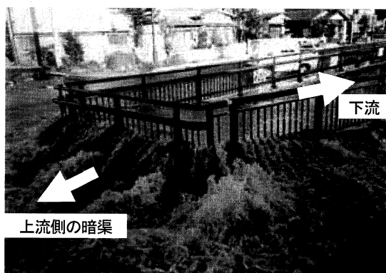
写真-2 暗渠前面での溢水状況 (2002年10月22日撮影)
