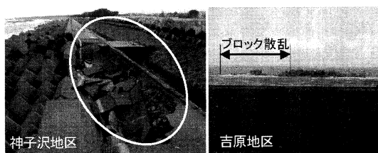
写真-6 海岸保全施設の被災状況
