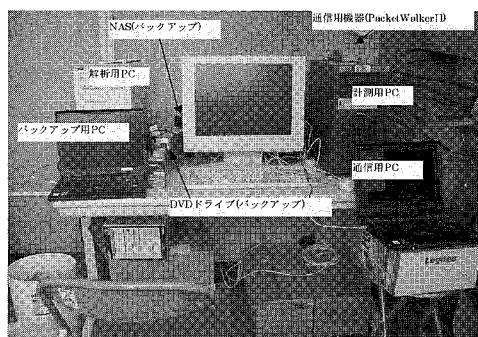
写真-1 通信サブシステムを設置した基地局内
