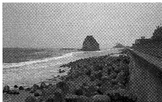
写真-6 ニツ島近傍の護岸状況
