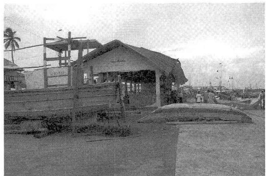
写真-3 Hikkaiduwa 漁港で一部破損した漁港施設
