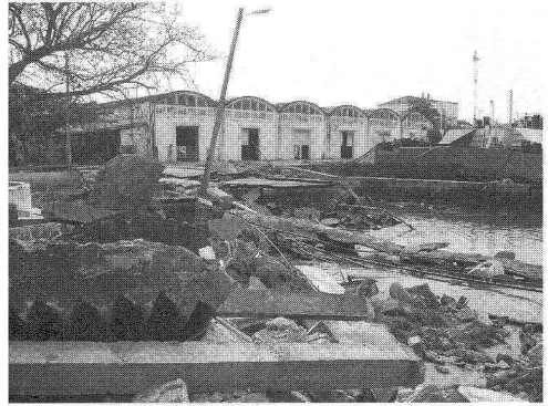
写真-1 Galle 港における岸壁の破壊
