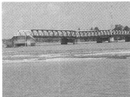
写真-2 洗掘を受けた橋脚と流出した橋台
