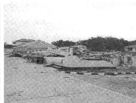
写真-2 背後建屋の被災
