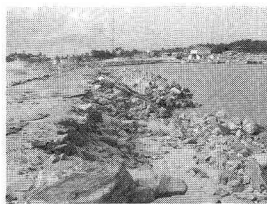
写真-1 防波堤被覆の被災
