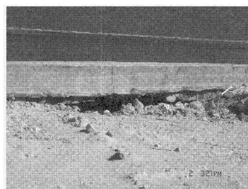
写真-2 陸から海への浸透流による空隙
