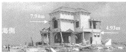
写真-3 中破家屋と津波痕跡 (Banda Aceh, 海岸から約 0.9 km 内陸)
