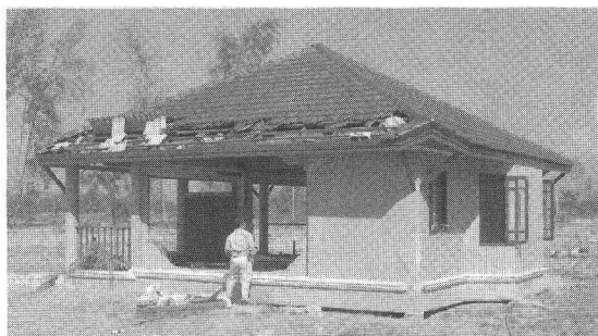
写真-3 Ban Ma Kap での津波被害
