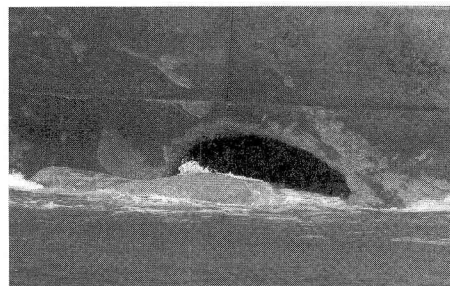
写真-1 ケーソン側壁の破壊状況 (国土交通省 宮崎港湾・空港整備事務所 提供)
