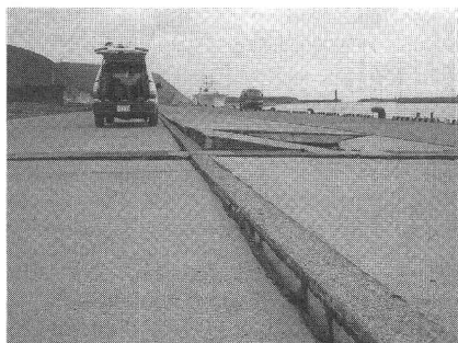
写真-5 室戸岬漁港における荷揚場舗装破壊
