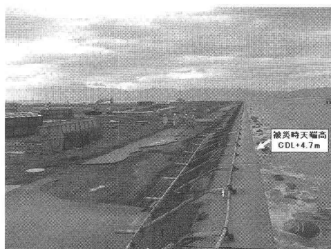
写真-3 南西側護岸セキュリティフェンスおよび場周道路破損 (関西国際空港株式会社 提供)
