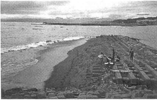
写真-1 河口左岸の横堤周辺状況 (2004年10月31日)
