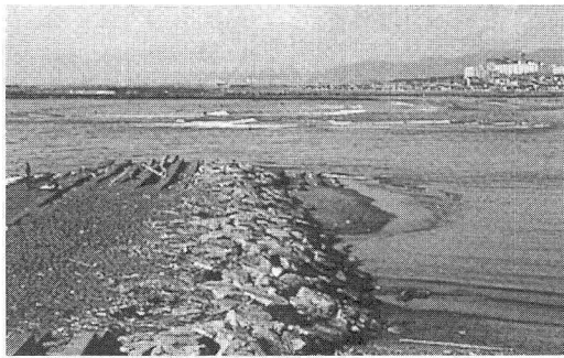
写真-3 横堤背後の砂州状況
