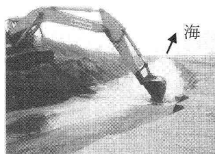
写真-1 河口閉塞・浚渫状況[1991年6月14～18日]
