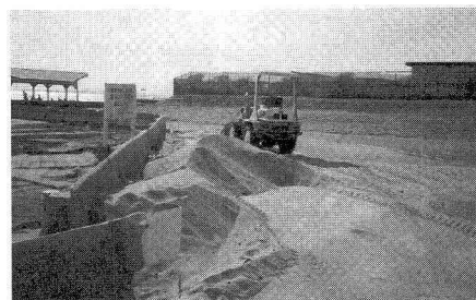
写真-4 護岸隅角部に堆積した飛砂
