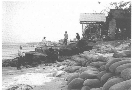
写真-4 突堤裏側の侵食状況
