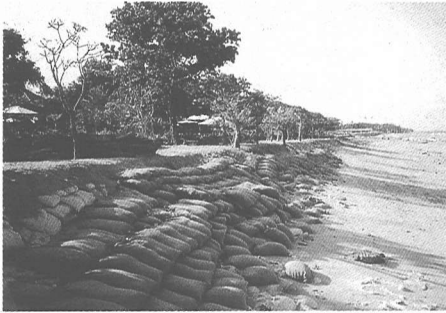
写真-5 突堤下手側の侵食と土嚢による対策
