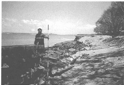
写真-2 護岸の被災状況 (2000年8月末)
