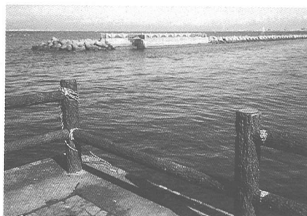
写真-2 突堤の手摺の損傷
