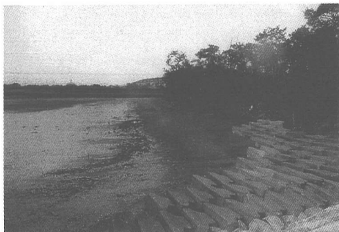
写真-3 大新田海岸護岸端部の状況
