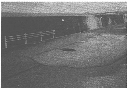
写真二 アスファルト舗装の陥没
