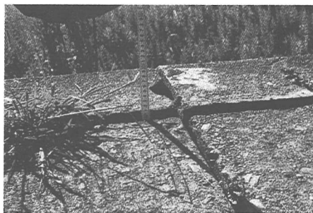
写真一 目地部における変状
