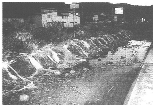
写真-7 応急対策区域 (大型土のう) の越波後の状況
