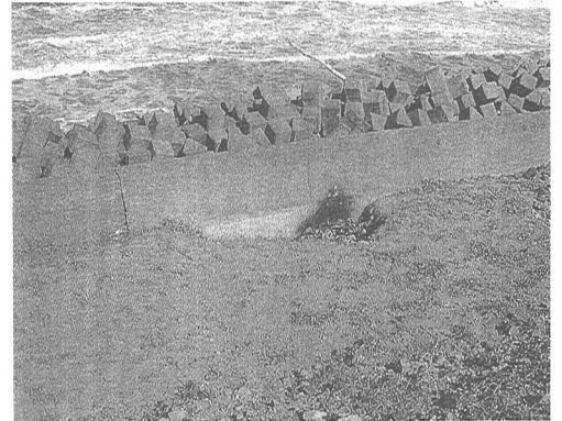
写真-3 護岸背後地の土砂吸い出し状況 (2002年5月6日撮影)
