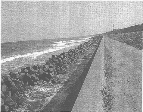
写真-1 大洗海岸の護岸露出状況 (2002 年 5 月 6 日撮影)
