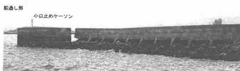
写真-1 背後に傾斜した L 型塊と無被災のケーソン
