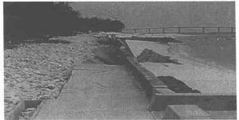
写真-3 侵食災害
