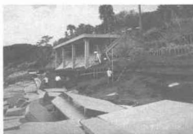
写真-6 緩傾斜護岸被災例（長崎鼻）
