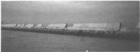
写真一 傾斜した護岸
