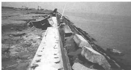
写真-2 倒壊した護岸
