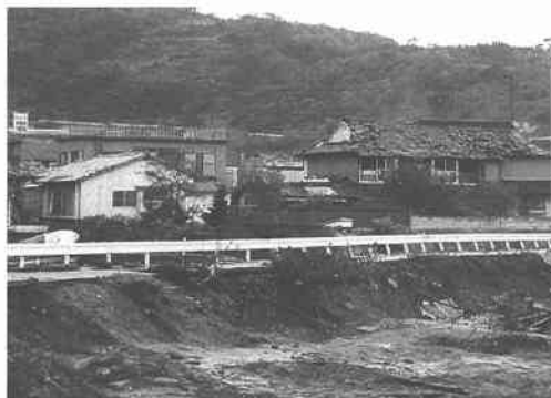
写真-2 和田船溜背後の越水による法面洗掘状況
